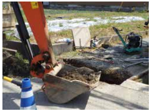
市道脇の水路から大きな樹への土管が破損
