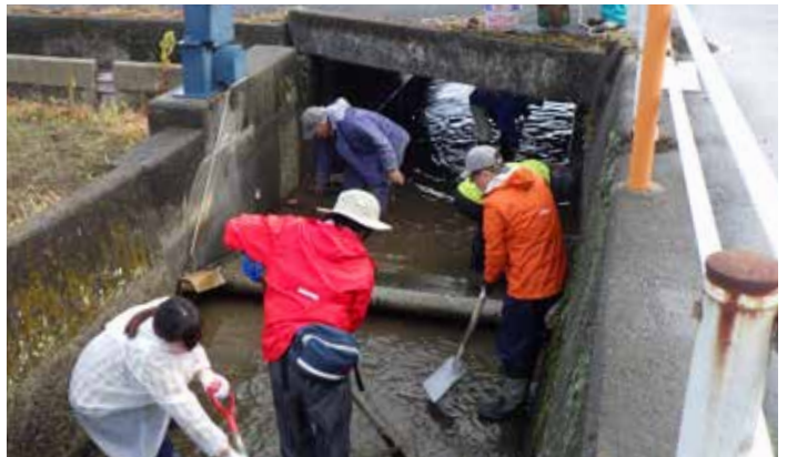
水路の調整ゲートがあるところは堆積が多い
