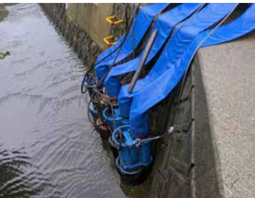
フル稼働では1分間に16トンの揚水能力
