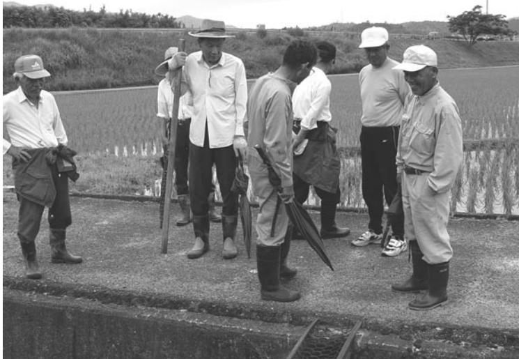
役員全員で水路を点検、傷みの激しさを確認しました
