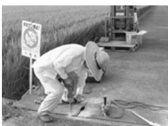
振動ドリルでコンクリートにアンカーボルト用の穴を加工
