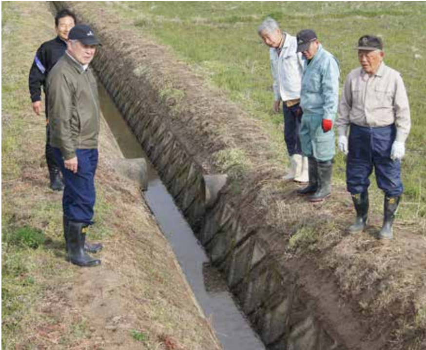
工事が終わったので、出来具合を確かめる完成検査を実施（3月16日）
