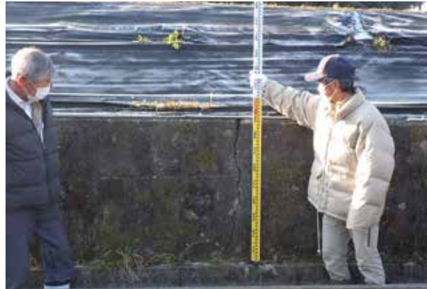
北側の擁壁は東詰めから8メートルの位置に亀裂
