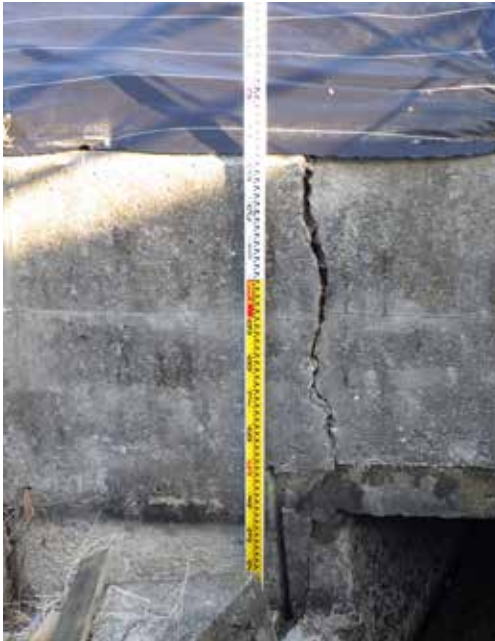
南側の擁壁は水路の暗渠に接する部分で大きな亀裂がある。子の暗渠との関係で亀裂が生じたのではないかとみられている
