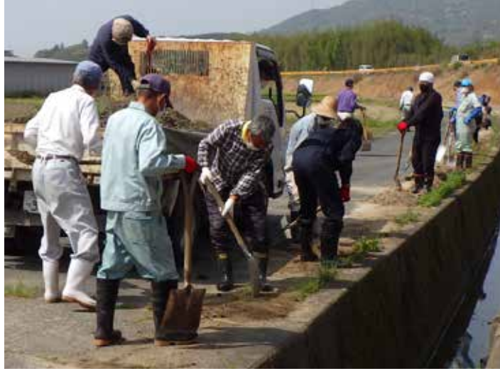
西側外周水路には相当の土砂、2トンドンプ2杯の量
