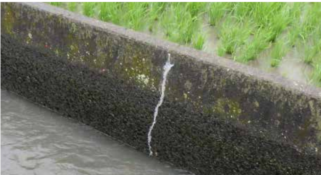
白く見える部分は経年変化できたひび割れに充填剤を入れたもの
