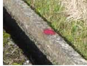
ペイントでマークした亀裂箇所
