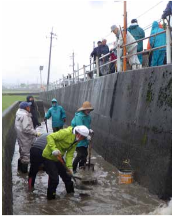
水路が広くなる場所や曲がるころには土砂がたまりやすい
