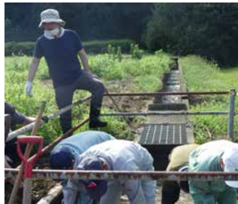
元高山造園の東側の沈砂池に大量の土砂がたまり、溢れ出た水が通路を破壊。沈砂池の土砂を除去
