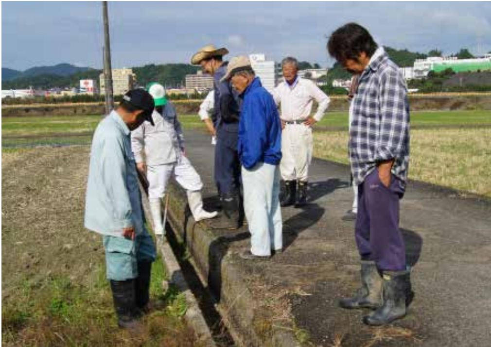
長年の水流でコンクリートの傷みが見られる
